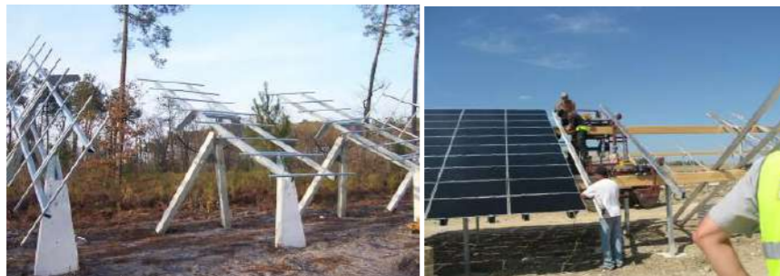
Photographie 5 : Montage des supports de la technologie « trackers » (à gauche), montage de modules sur des supports fixes (à droite)
